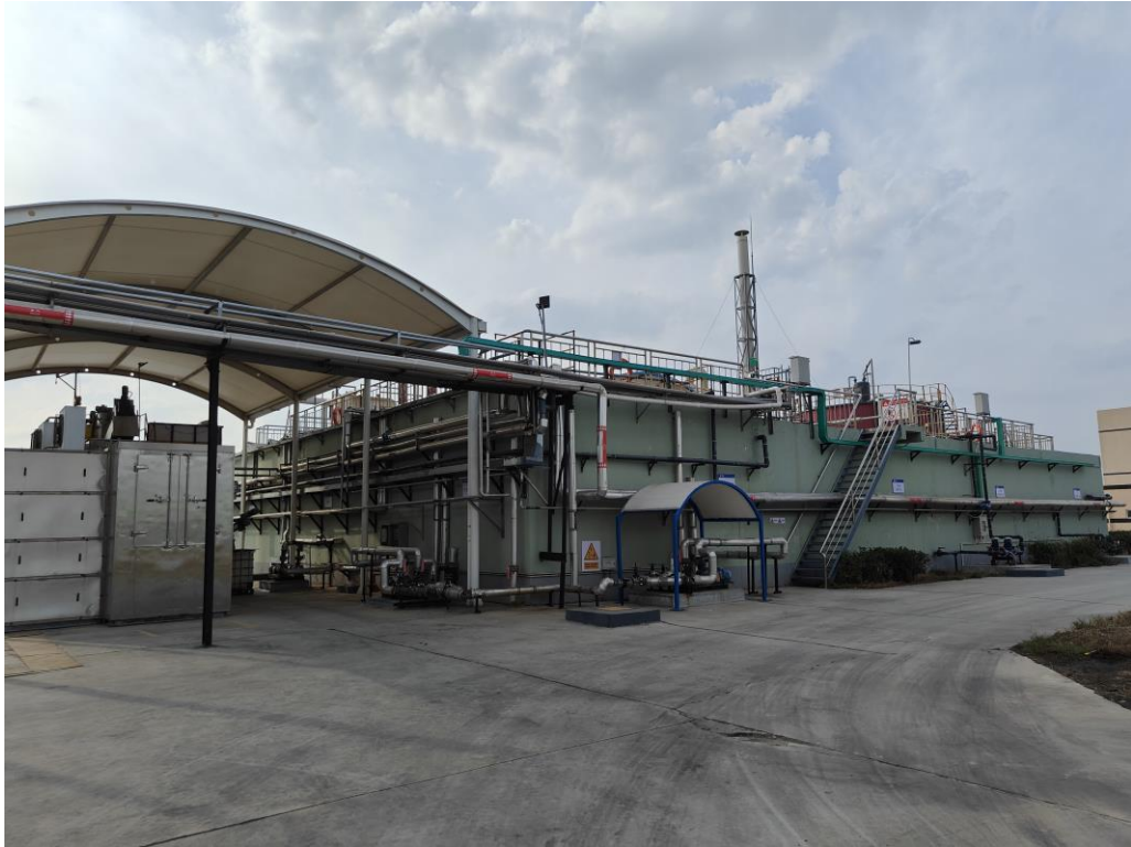
厂内污水处理站（半地下）
